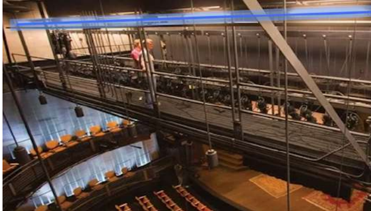
Pasarela tipo Catwalk con luminaria de color azul
