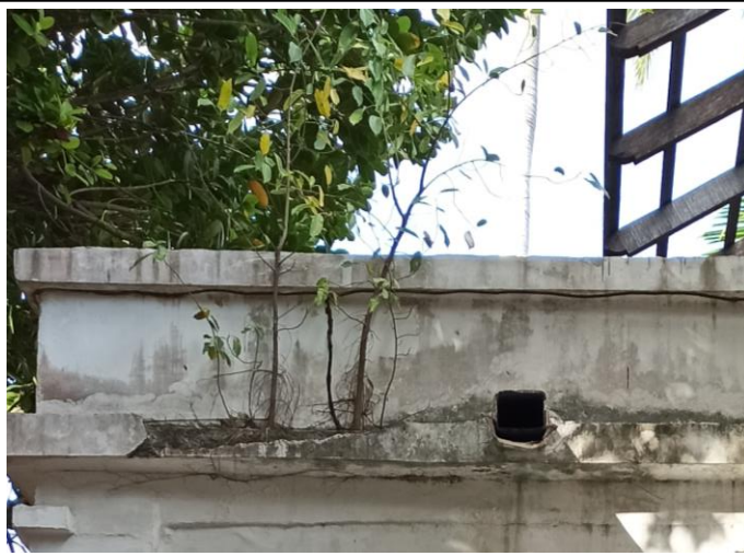
Foto No. 15 Ubicación Columna Ejes 5 con eje C
