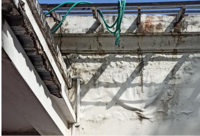
Foto No. 09 Ubicación Muro alto Eje B. Entre Ejes 2 y 1
