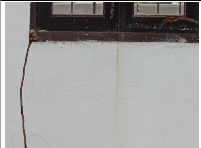
Foto No. 92 Ubicación: Ventana Oeste Entre ejes 4 y 5
