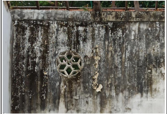
Foto No. 66 Ubicación Muro Alto Eje B. Entre Ejes 4 y 5
