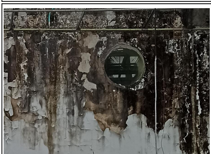
Foto No. 87 Ubicación Muro alto Eje B. Entre Ejes 1 y 2
