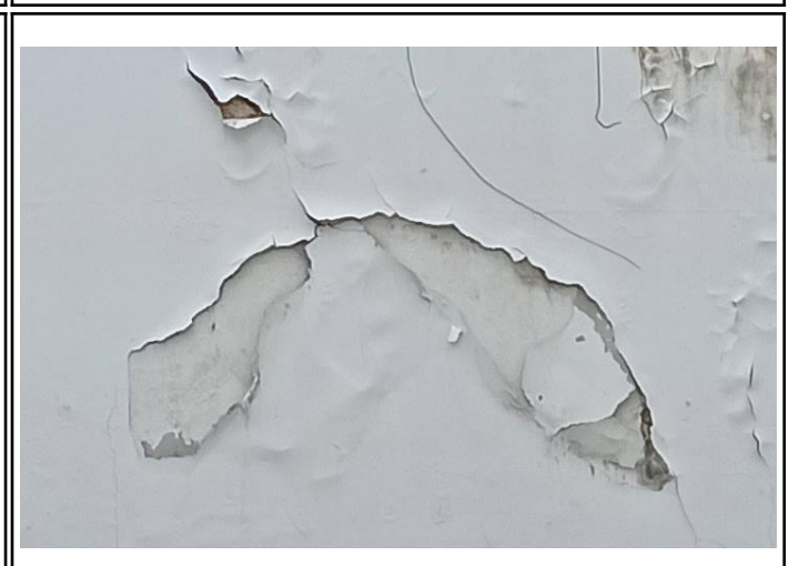
Foto No. 88 Ubicación Muro alto Eje B. Entre Ejes 1 y 2
