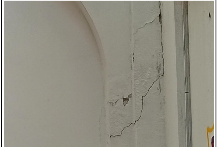
Foto No. 10 Ubicación Muro alto Eje B. Entre Ejes 2 y 3
