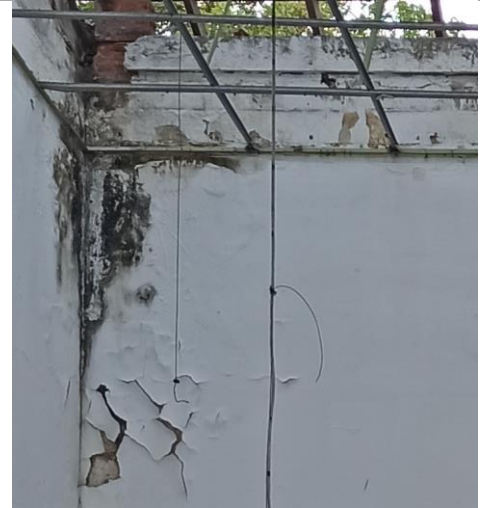
Foto No. 90 Ubicación: Muro alto Eje B. Entre Ejes 1 y 2
